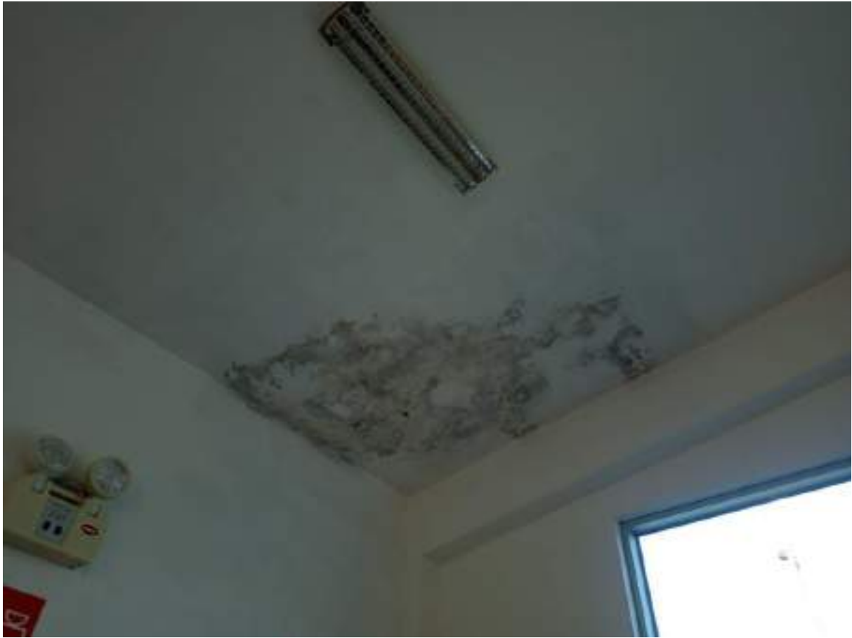
Techos agrietados y ventanas que filtran agua.
