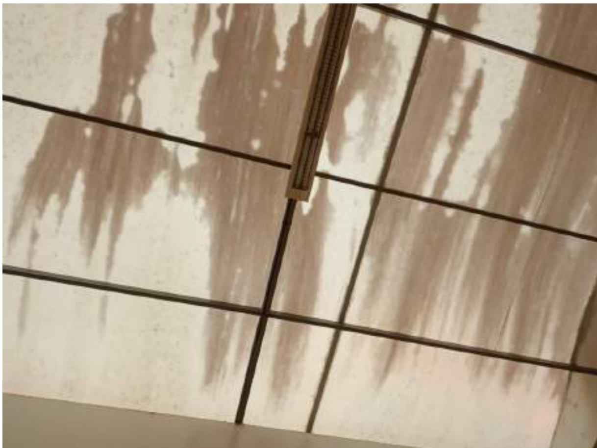
Filtración de agua por las ventanas
