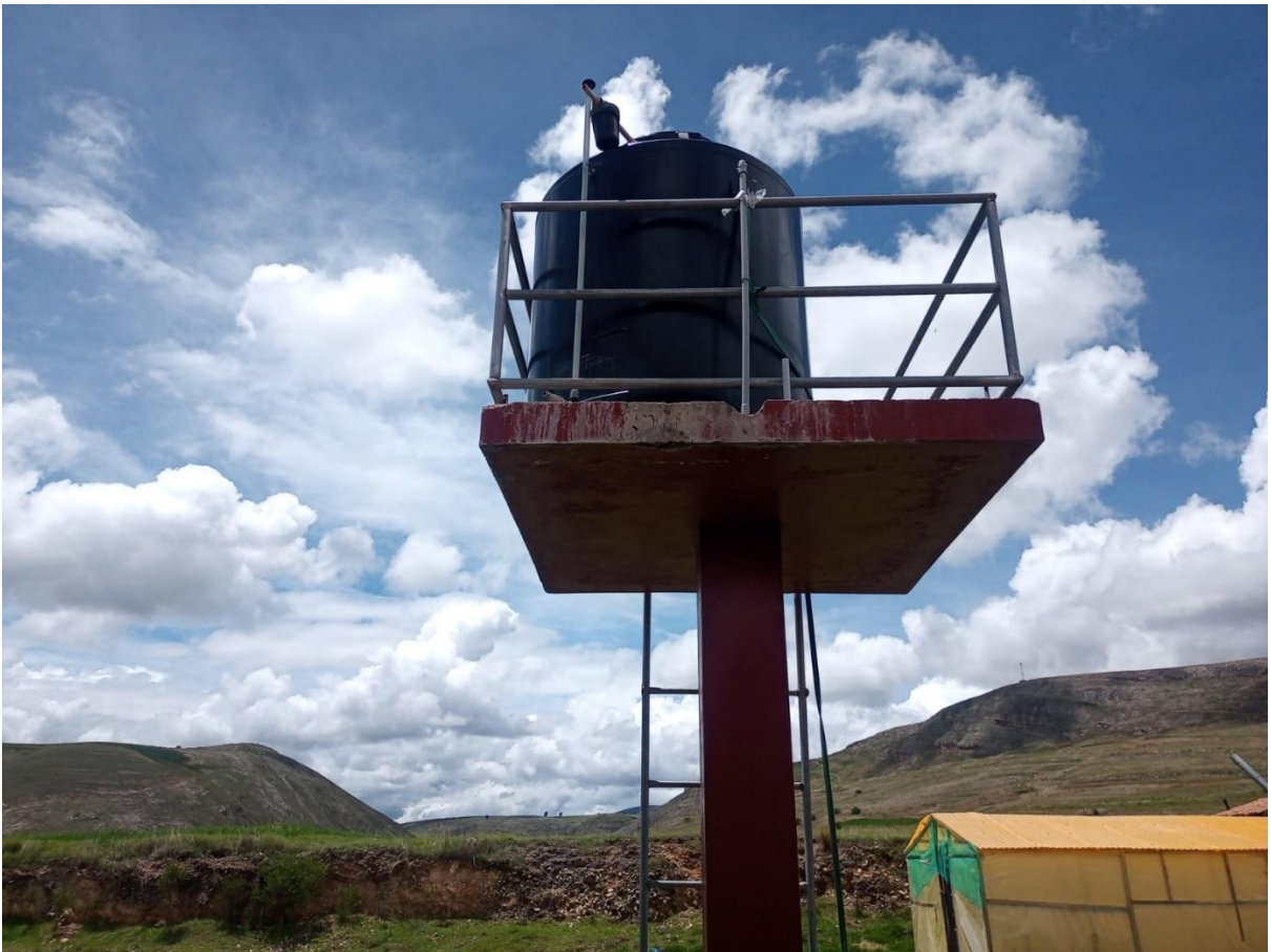
6.-Dos (02) fotografías del tanque cisterna en mal estado
