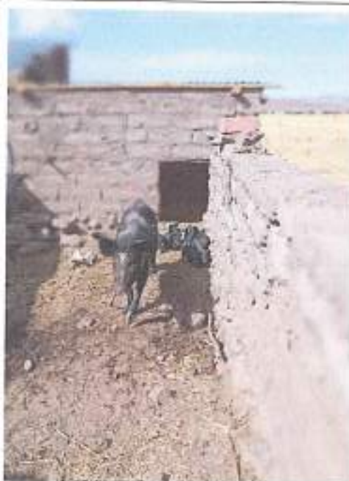
SE NECESITA REALIZAR MEJORAS EN EL GALPÓN DE PORCINOS.
