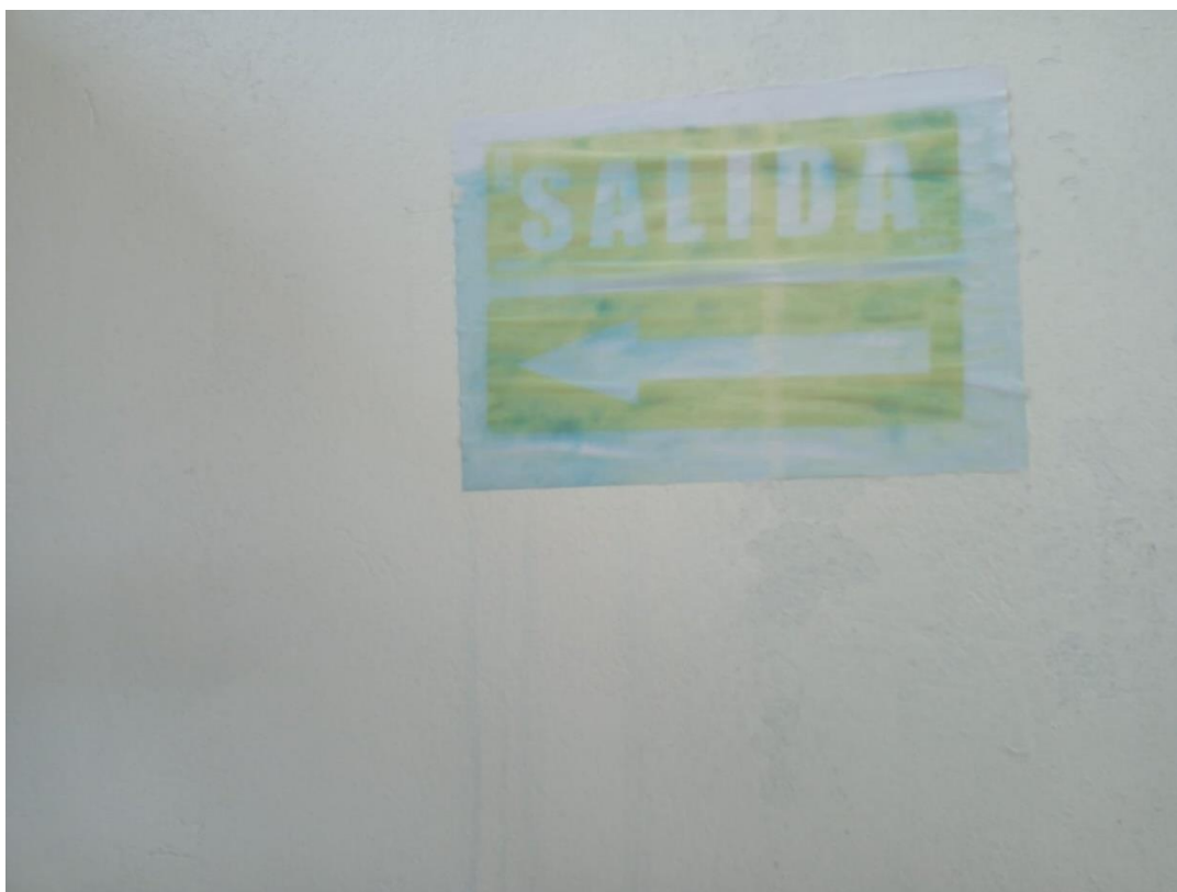
Manchas de agua en el techo y pared.
