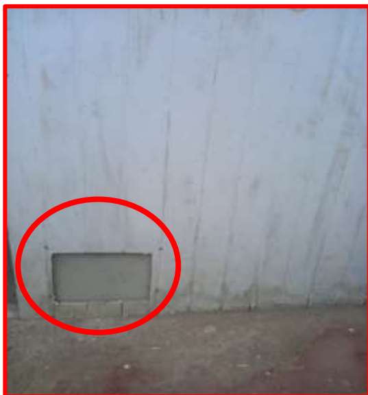
Imagen 003 se observa el agujero sellado
