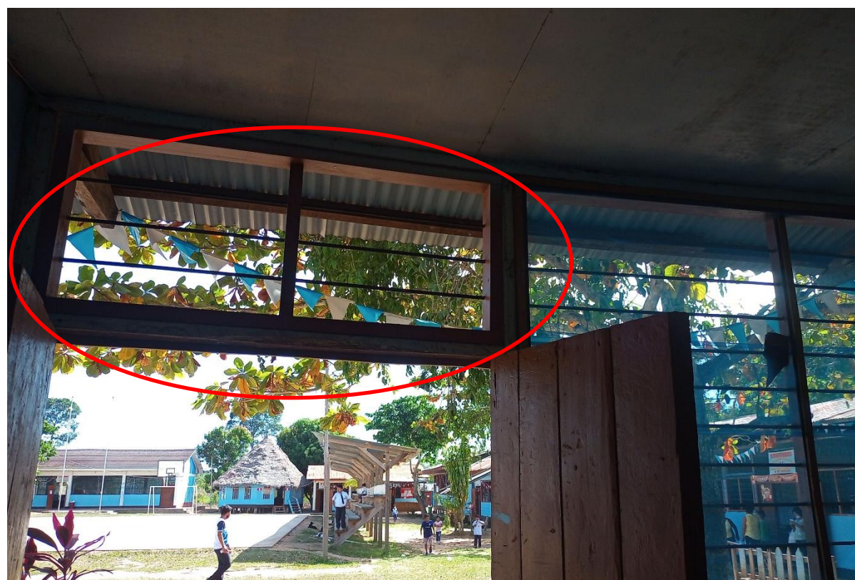
Fotografía 02: tragaluz de puerta no cuenta con mallas de protección que eviten el ingreso de animales
