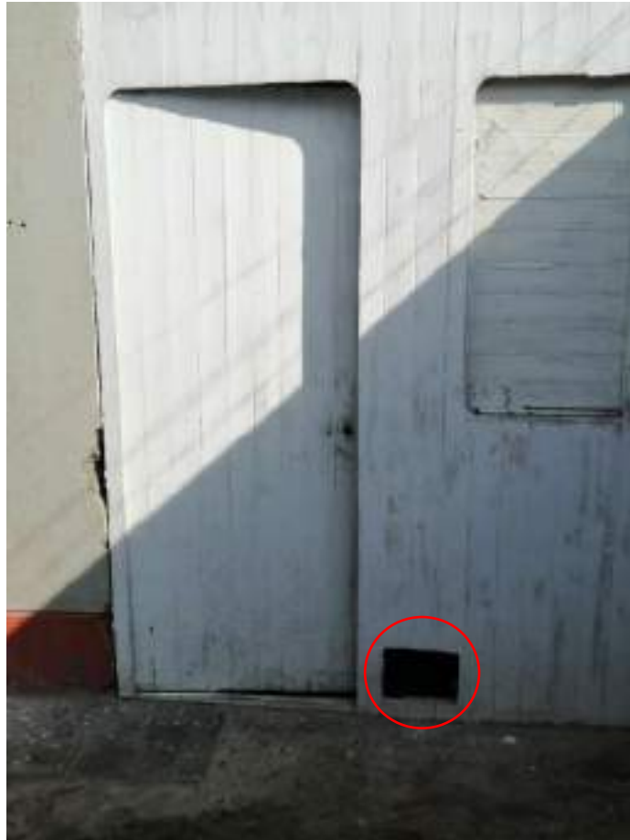
Fotografía 1: Se observa un agujero cerca a la puerta del almacén de productos del Programa que permite el ingreso de animales al almacén de alimentos.
