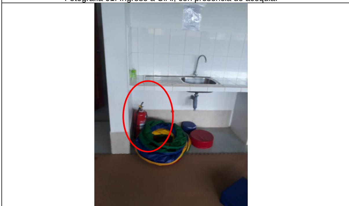
Fotografia 02: Extintor mal ubicado.
