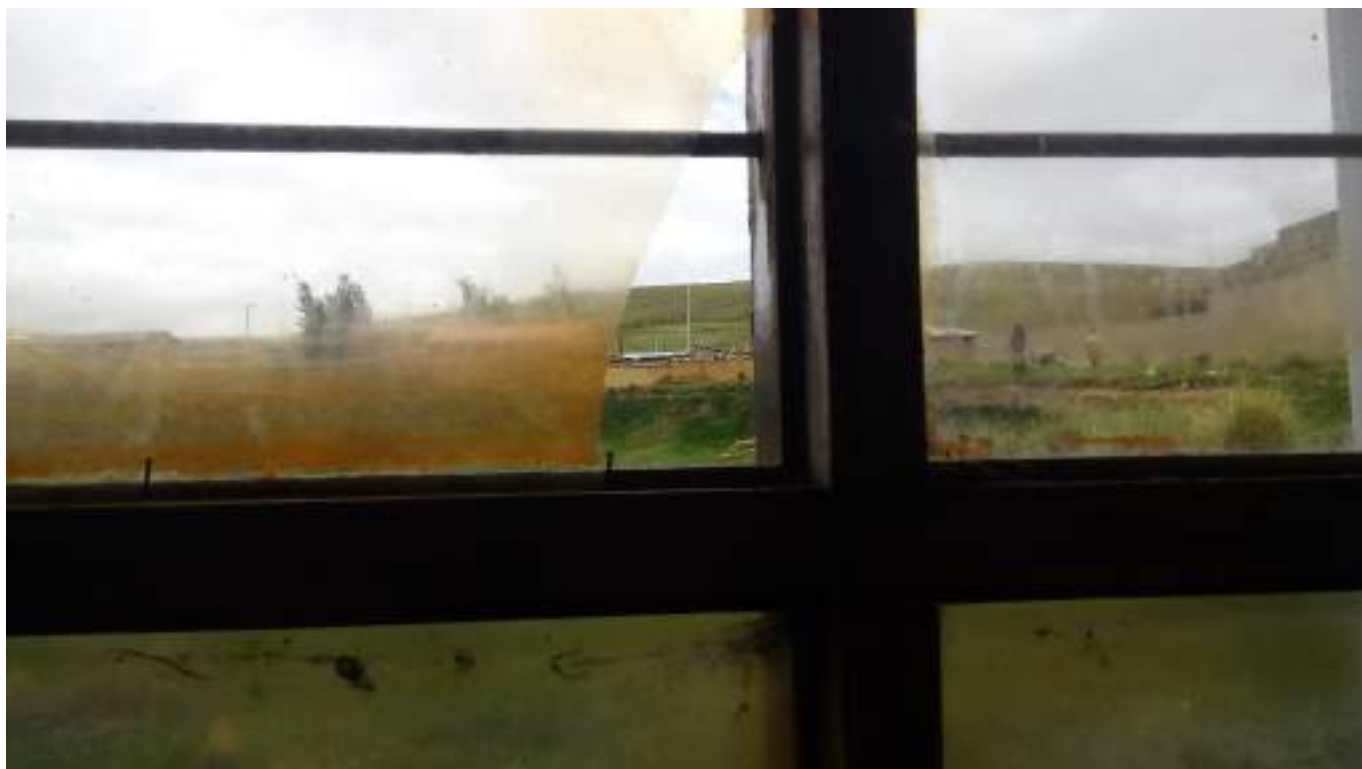
VENTANAS EN MAL ESTADO
