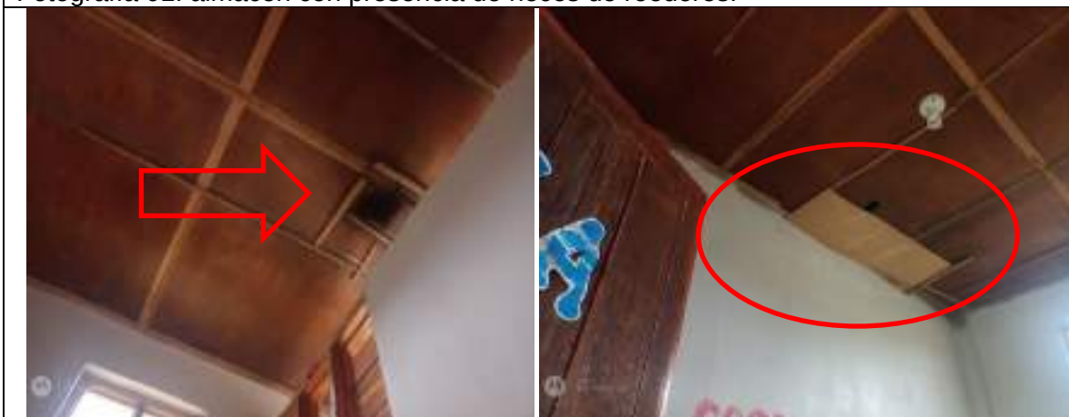
Fotografía 02: aberturas por donde ingresarían los roedores.
