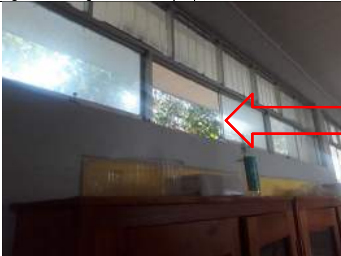
Fotografía 02: ventanas de vidrio que no pueden ser cerradas por deterioro.
