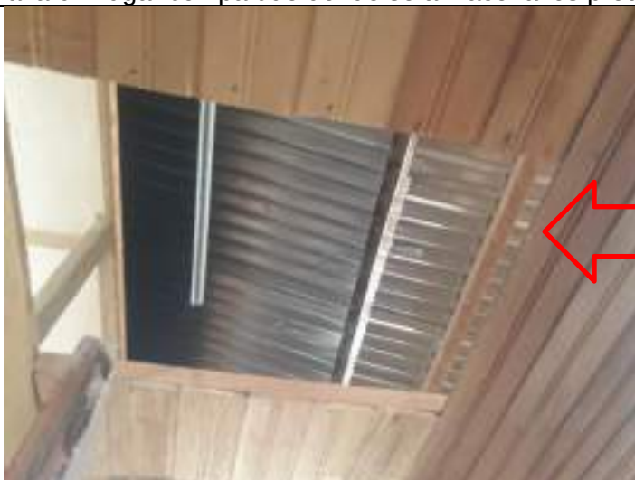
Fotografía 02: tragaluz que no tiene protección.
