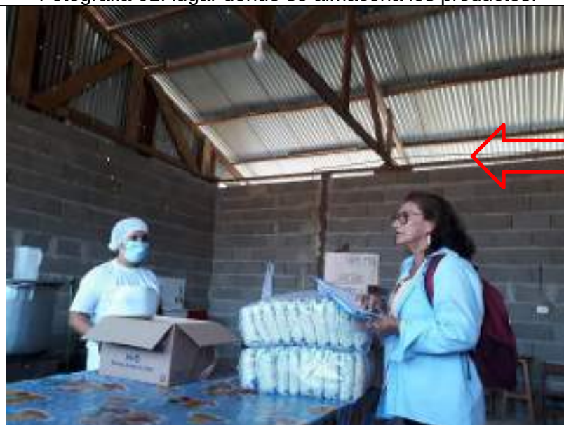
Fotografia 02: tragaluz que no cuenta con proteccion contra el ingreso de animales o insectos.
