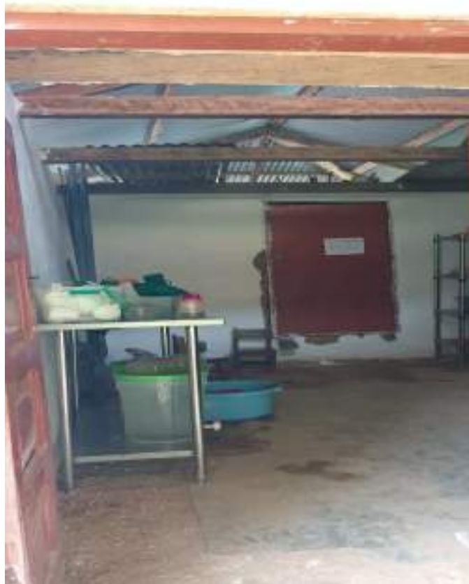
Anexo 03: Fotografía: Del lugar donde se preparan los alimentos no se encuentra protegido del ingreso de insectos y animales (no cuenta con cielo raso)
