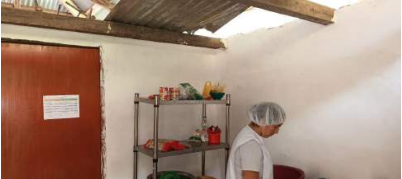
Anexo 02: Fotografía: Del lugar donde se preparan los alimentos no se encuentra protegido del ingreso de insectos y animales (no cuenta con cielo raso)
