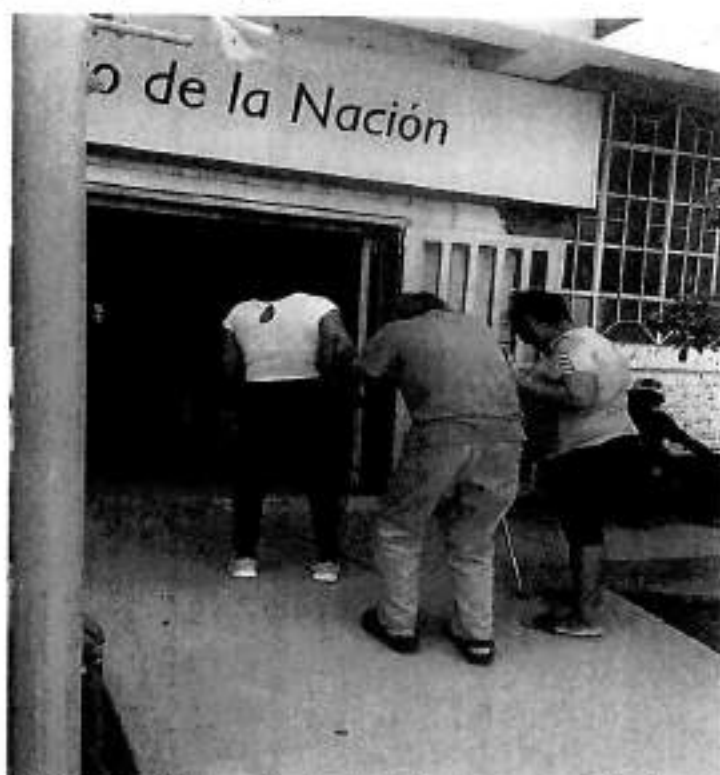
Rampas sin barandas y usuarios expuestos al sol
