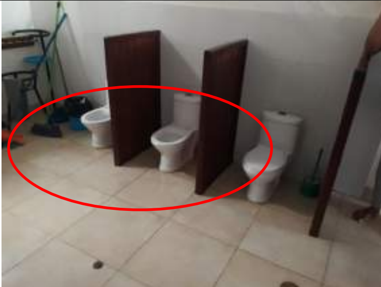
Fotografia 03: dos inodoros sin tapa.
