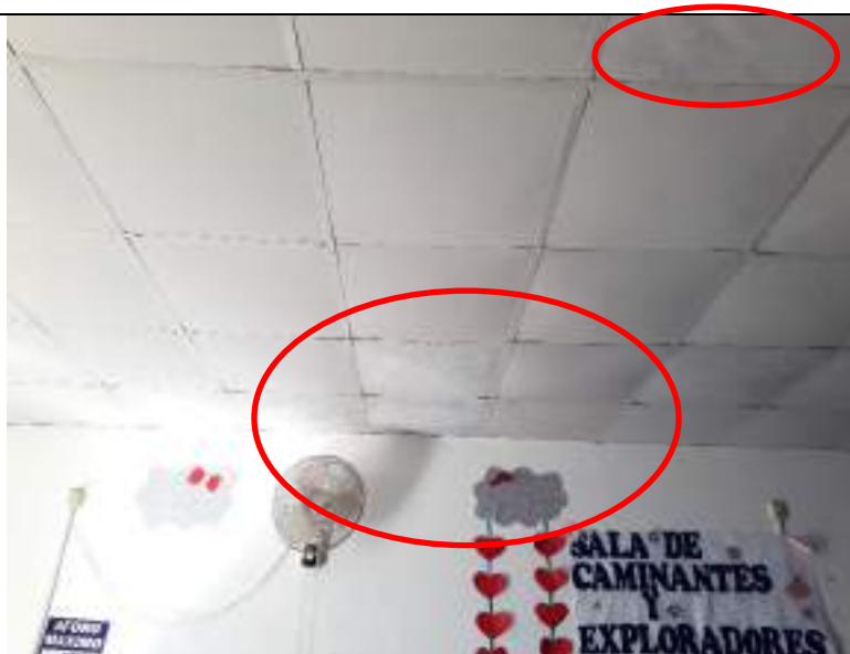
Fotografia 01: Presencia de goteras en el techo.
