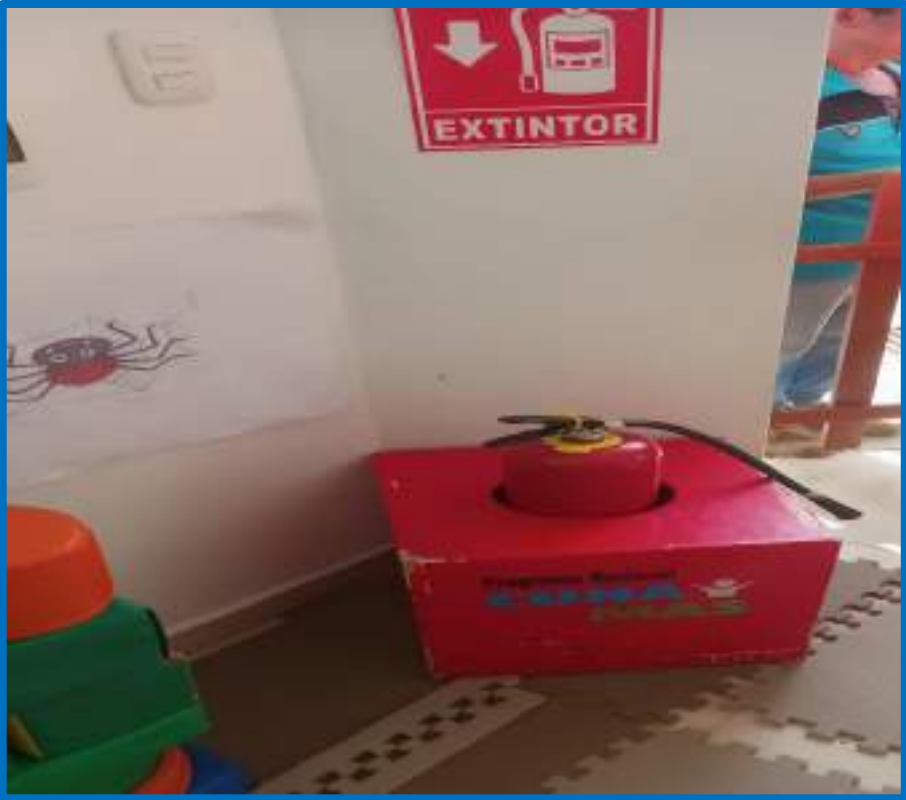
Anexo 06: Extintor en la sala Mixta
