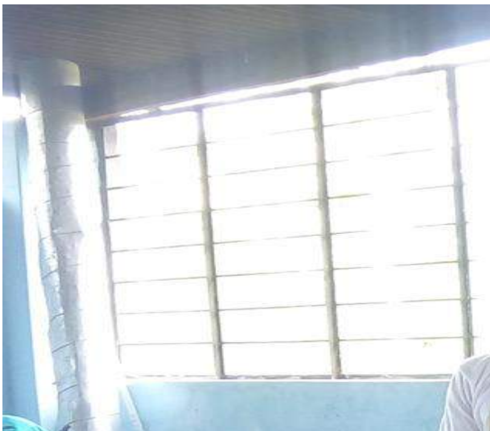
VENTANA SIN PROTECCIÓN
