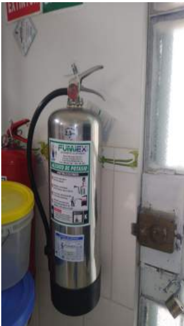
Anexo 14 –Extintor de acetato de potasio se encuentra con fecha de vencimiento vigente
