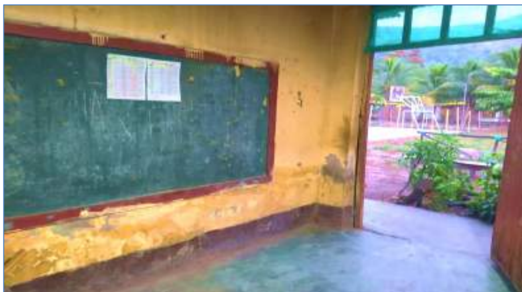
Imagen 04: acción correctiva sobre limpieza y desinfección del ambiente de preparación de los alimentos en la IE 38834 – San Antonio.
