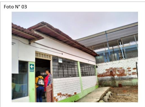
Vista de una de las Salas de Cuidado Diurno, no tiene un adecuado sistema de evacuación de aguas pluviales.
