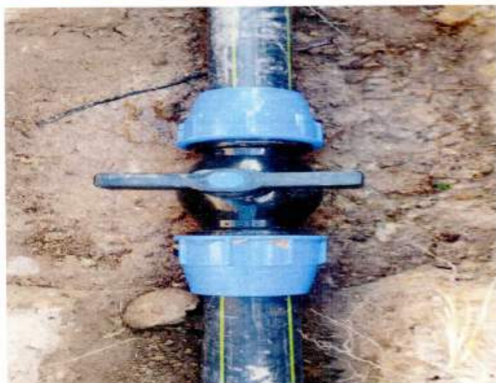
Las válvulas de salida instalada en los reservorios
