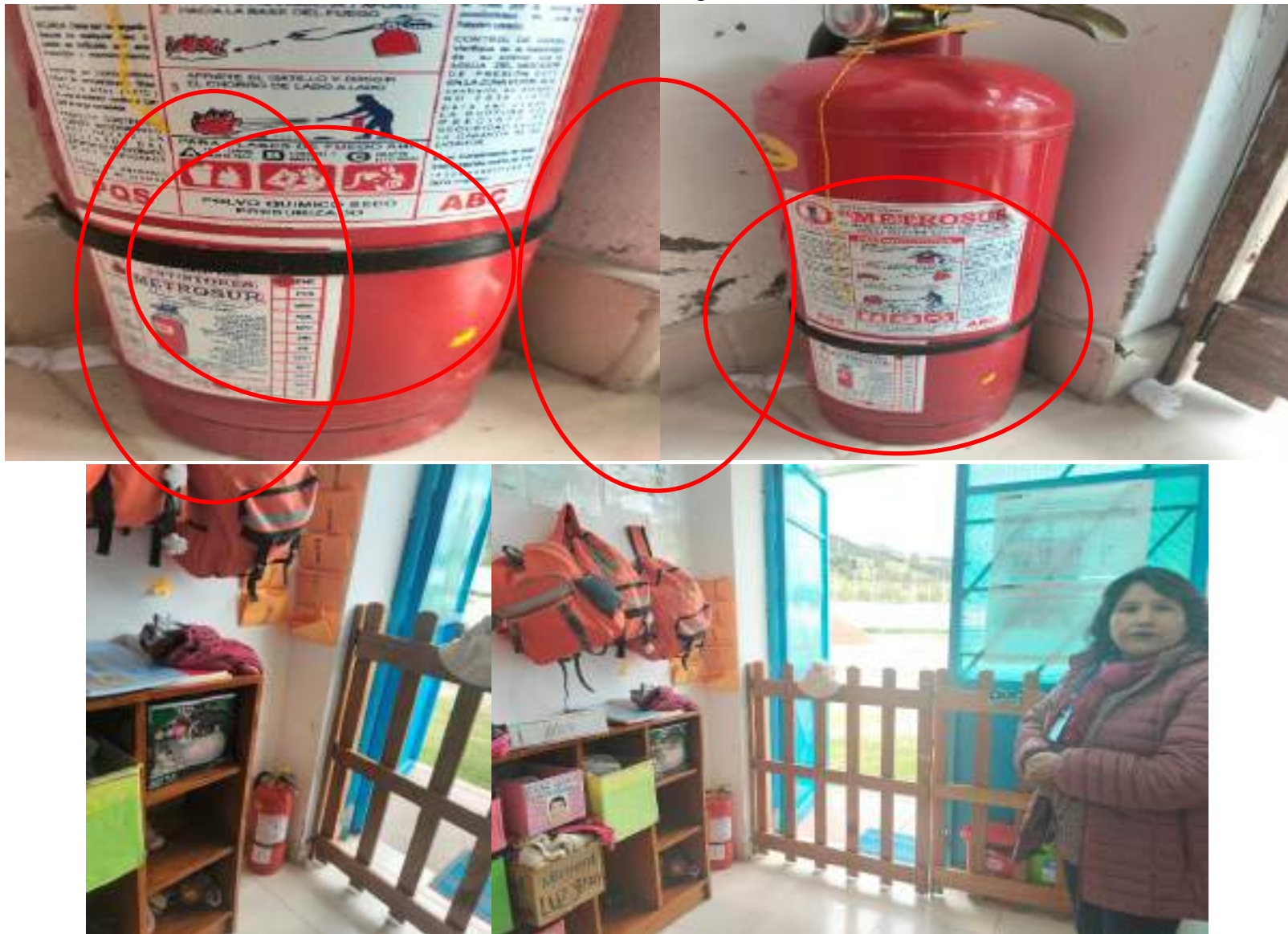
FOTOGRAFIAS DE EXTINTOR EN CIAI
