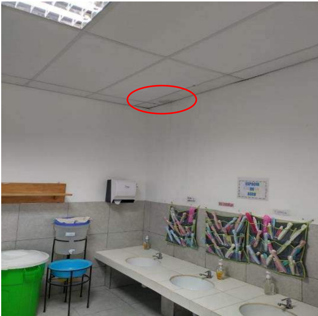
Anexo 5 -Empozamiento de agua en el techo en el espacio de aseo
