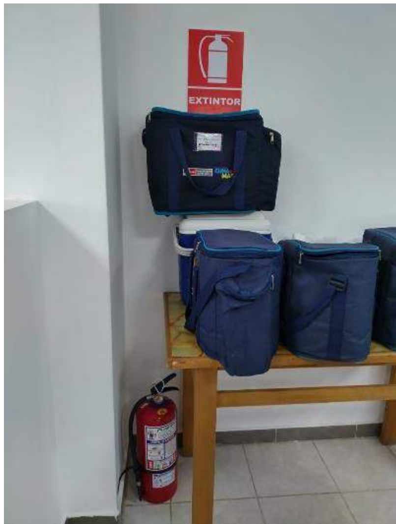
Anexo 7 -Extintor se encuentra ubicado al alcance de los niños.
