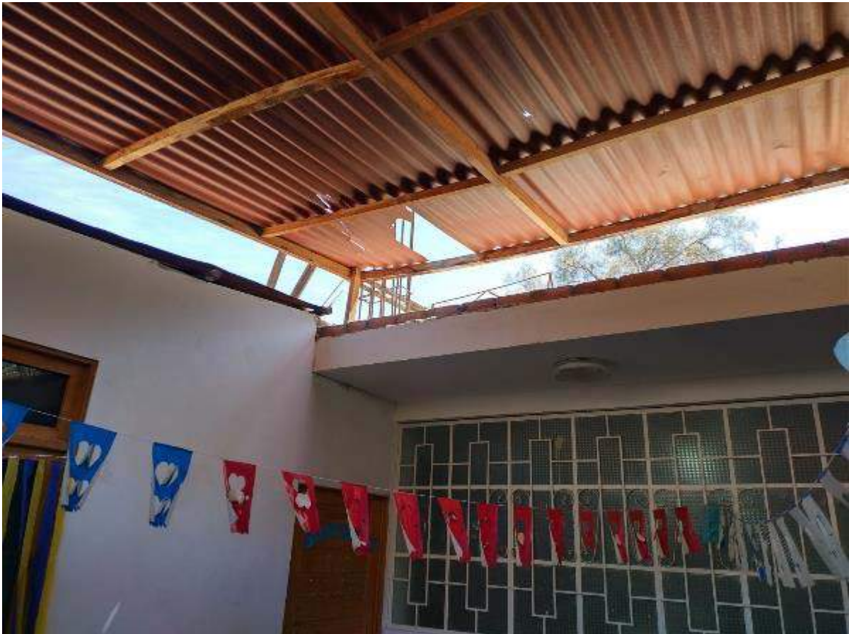
Anexo 3 – Techo que protege al patio del CIAI donde utilizan temporalmente para espacio de juego y espacio de alimentación con fisuras y roturas dejan paso a corrientes de aire y agua.
