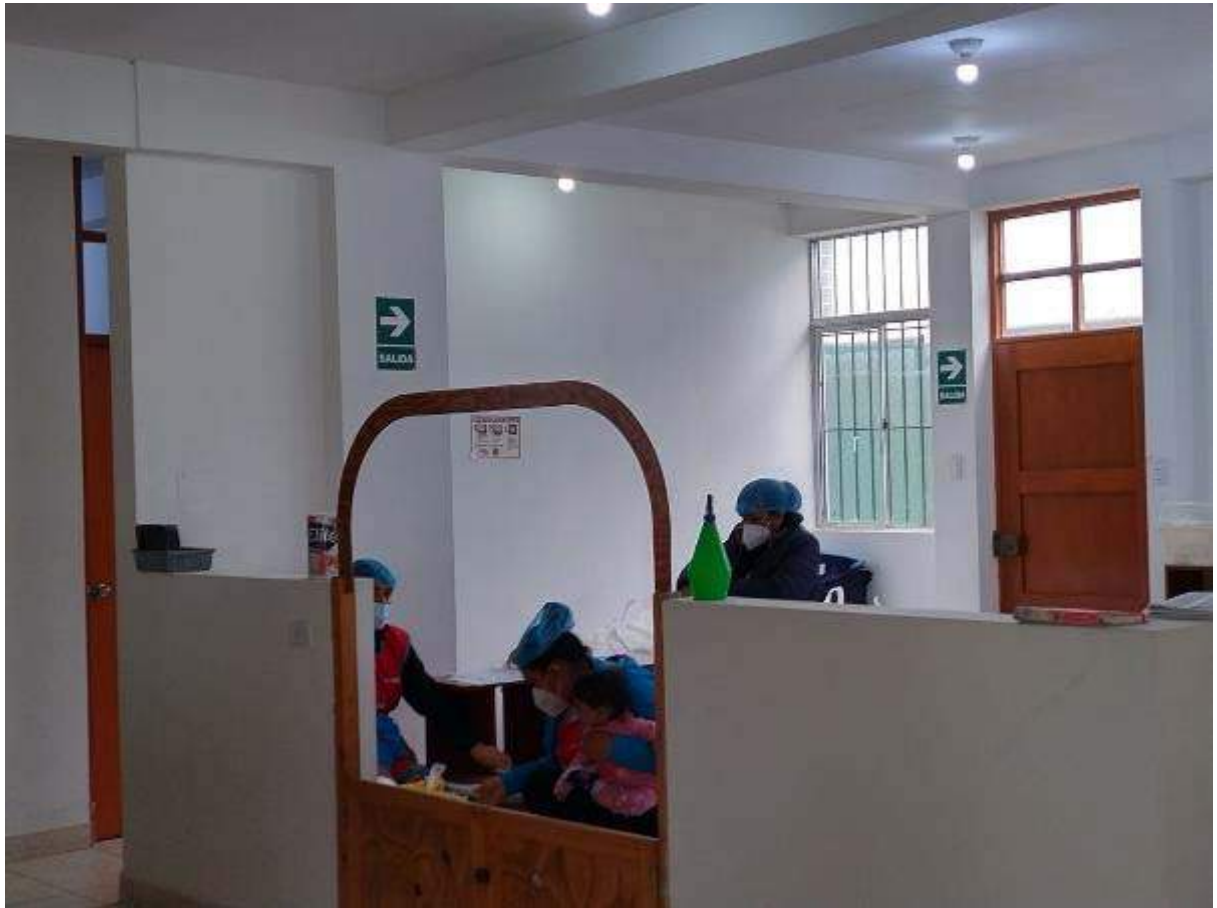
Anexo 3 -señalética solo cuentan con señalizaciones de evacuación y mas no de zona segura
