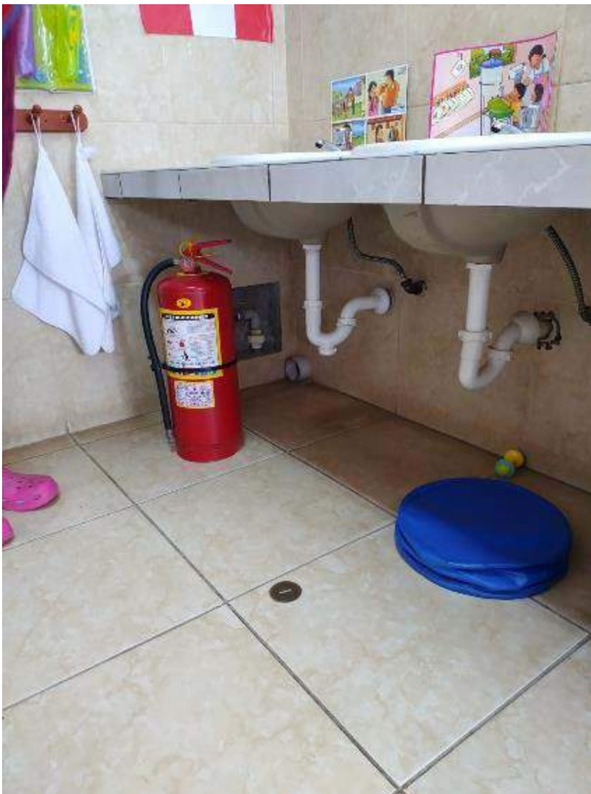
Anexo 2 - Sala de Caminantes y exploradores – El extintor se encuentra ubicado al alcance de los niños.
