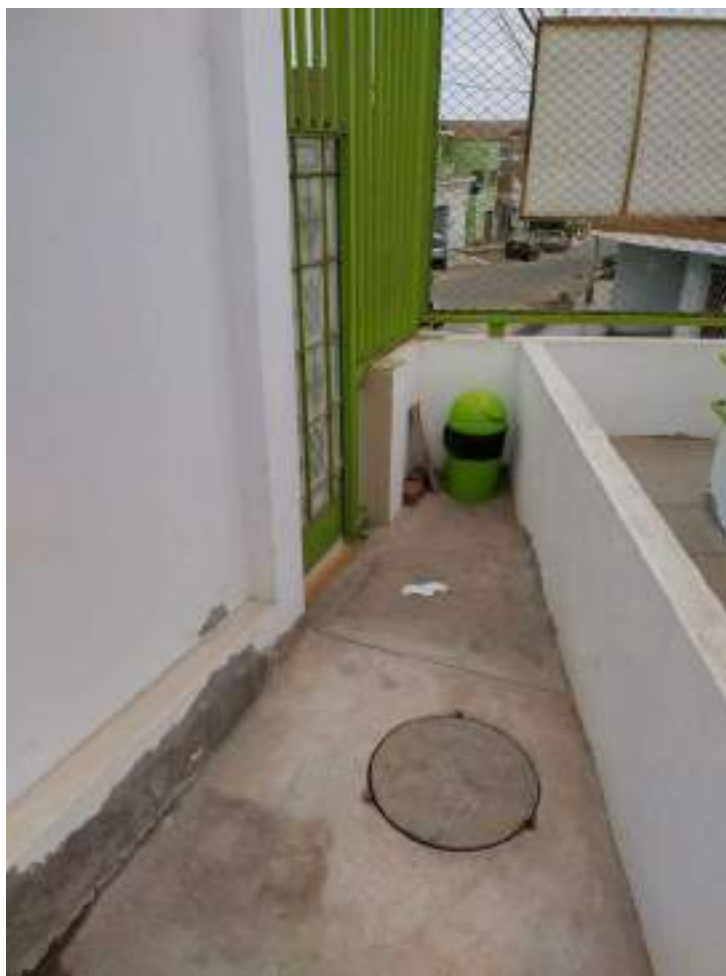
Anexo 6 – En entrada al CIAI las marcas de distanciamiento se encuentran deterioradas
