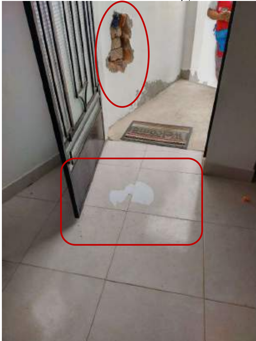
Anexo 5 – Marcas de distanciamiento en deterioro, aún no se instala la caja para luz eléctrica aún sin instalar
