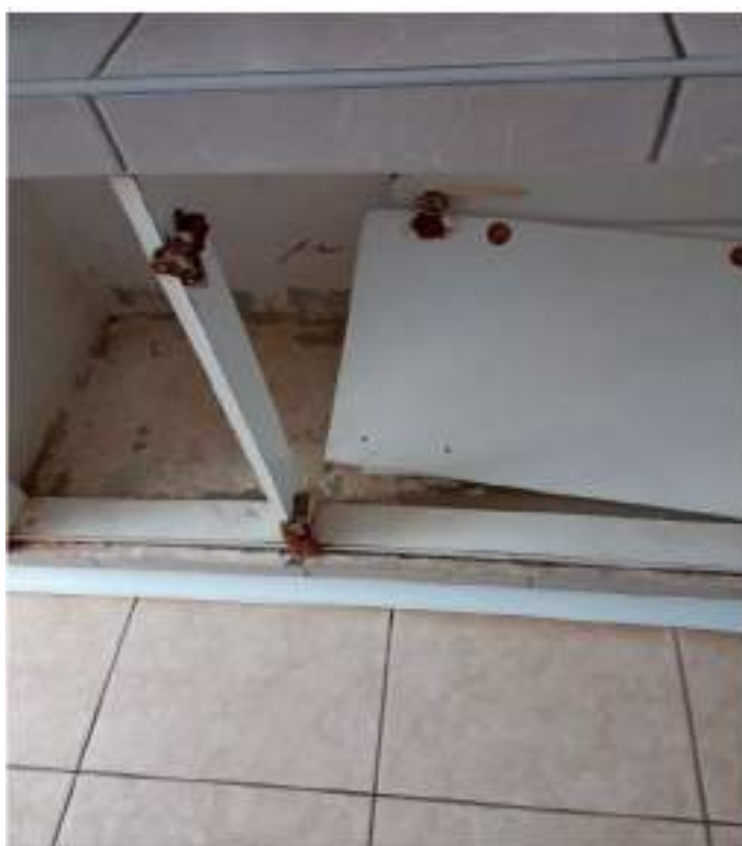
Anexo 4 – L a mismo se observa un deterioro en accesorios de la cocina
