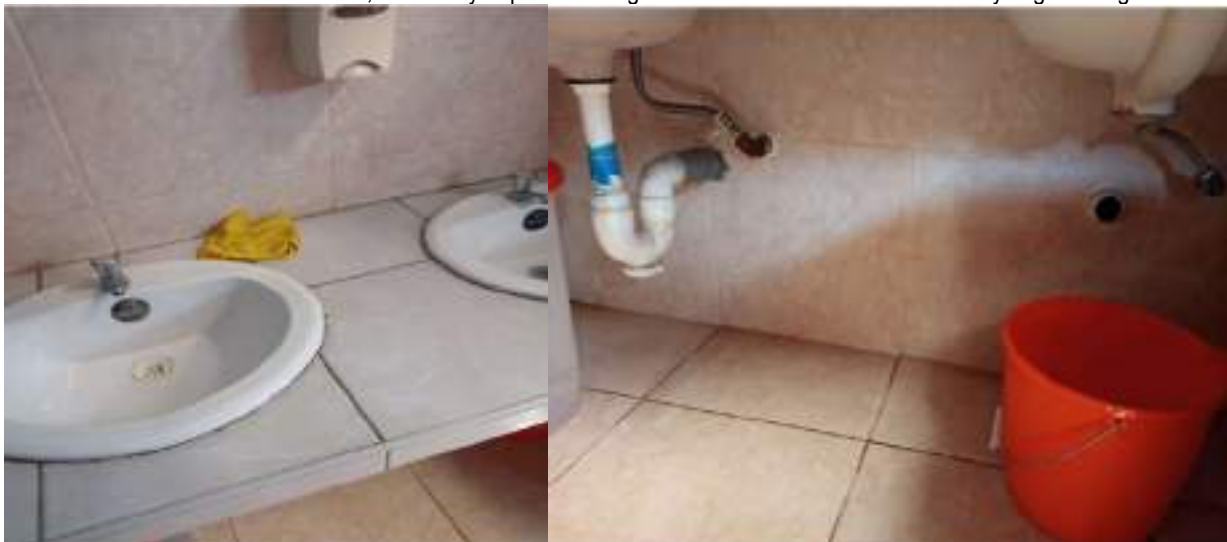
Anexo 2 accesorios de los lavaderos, inodoros y depósitos de agua deteriorados en consecuencia hay fugas de agua
