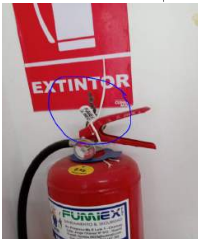
Anexo 2 – Se observa el extintor de incendios mal empotrado
